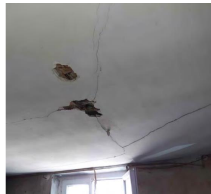
Planchers non conformes
