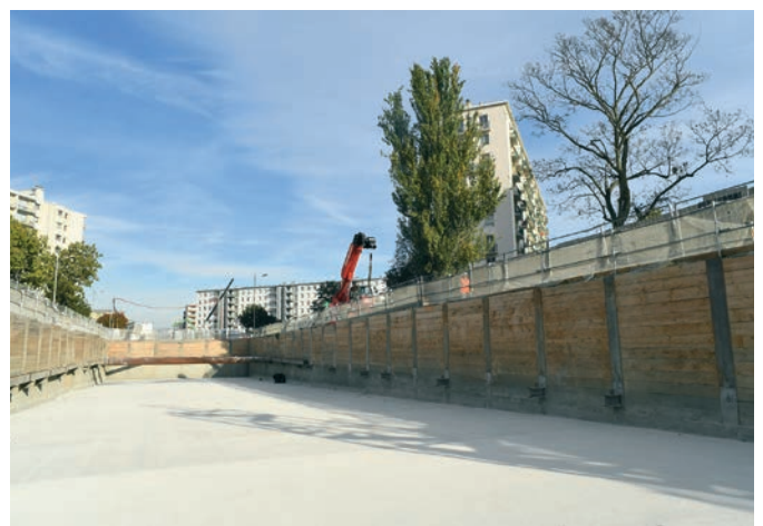
La dalle supérieure d'une partie du tunnel d'arrière gare, se situant sous l'avenue Henri-Barbusse, a été coulée en octobre. La tranchée va ensuite être remblayée jusqu'au niveau de la rue.
