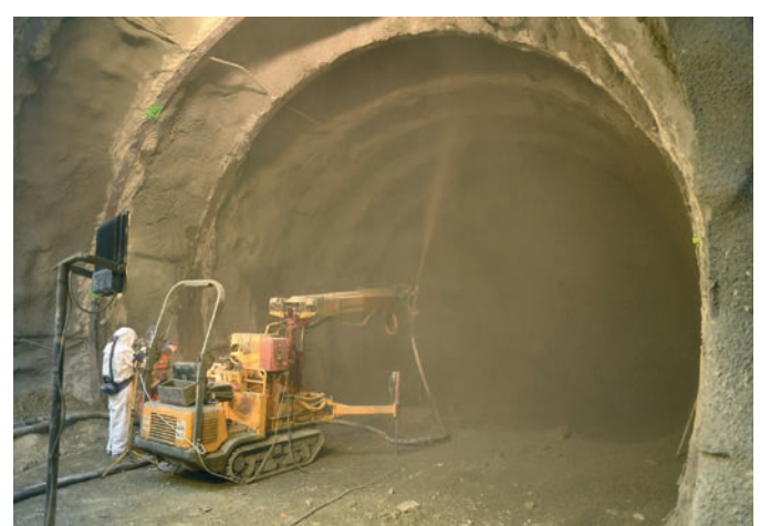
Au fur et à mesure du creusement du tunnel, du béton est projeté sur les parois pour tenir les terres, avant de réaliser le coffrage définitif du tunnel.
