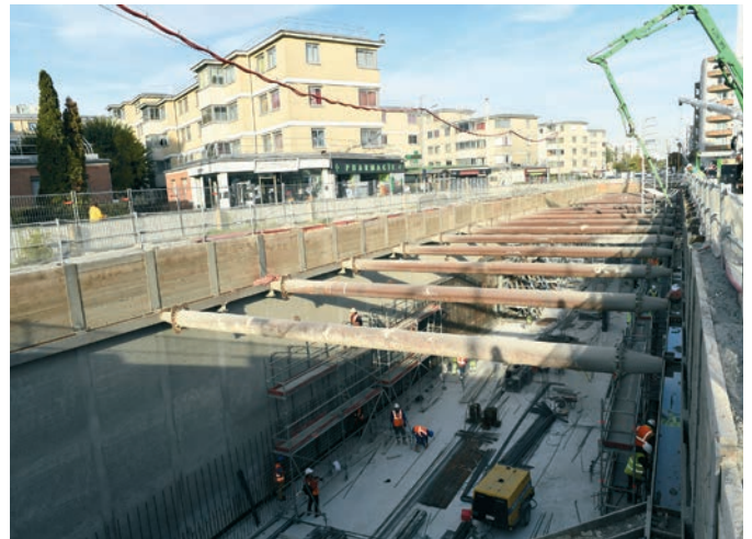
Les poutres métalliques horizontales, appelées également butons, permettent de tenir les parois verticales du tunnel en cours de construction. Elles seront retirées dès que ce tronçon sera achevé.
