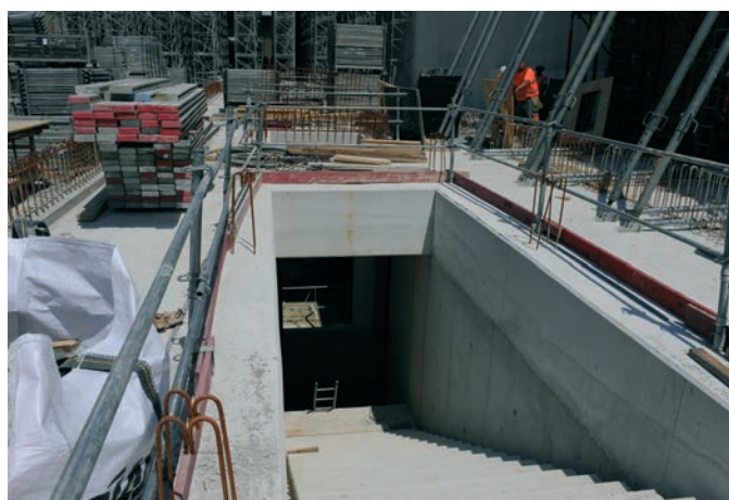
Sur le quai de la future station terminus de la ligne 4, les passagers emprunteront cet escalier pour rejoindre la ligne 15 du Grand Paris Express.
