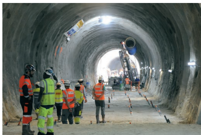
Pour se préserver des fortes chaleurs à la surface, il se rend de temps en temps dans les tunnels. Ce tunnel rejoindra d'ici peu celui creusé depuis le carrefour Marx-Dormoy, où sera située la future station Verdun.
