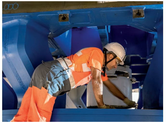
Les ouvriers assemblent les différents morceaux de la roue de coupe, qui débutera son travail en janvier, en tête du train-usine de 100 mètres de long.
