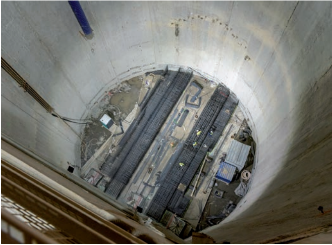
Tout au fond du puits, à 42 mètres sous terre, les ouvriers préparent la plateforme d'où partira le tunnelier en direction de la gare Fort-d'Issy-Vanves-Clamart. Il avancera de 10 à 12 mètres par jour jusqu'à l'été 2020.
