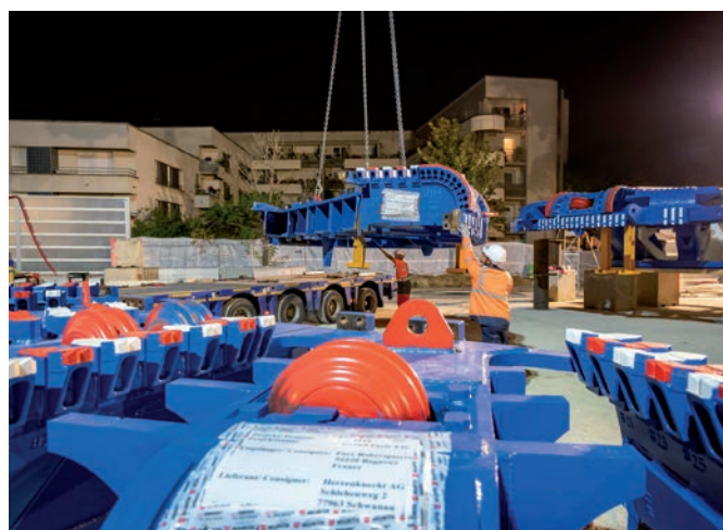
Les camions se succèdent avec de nouveaux morceaux de la roue de coupe qui, une fois assemblée, composera un cercle parfait de 10 mètres de diamètre : la dimension du tunnel.
