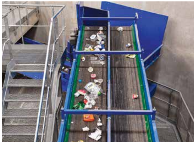
Dernière étape : le tapis bleu achemine les matériaux vers l'espace de stockage. Le centre traite au total 32 000 tonnes de déchets par an, soit dix tonnes par heure, et emploie 63 personnes.
